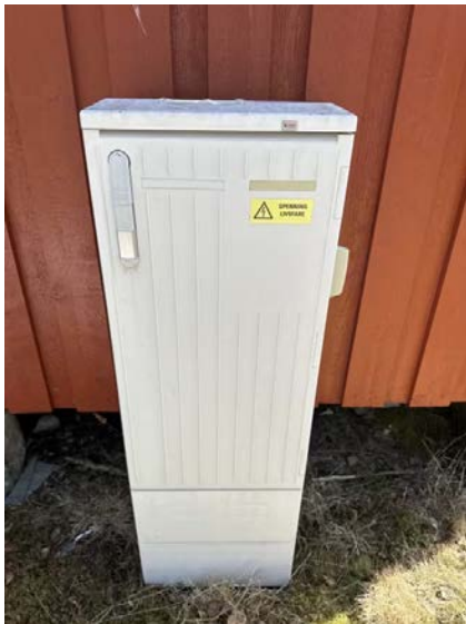
Viser utvendig målarskap.
