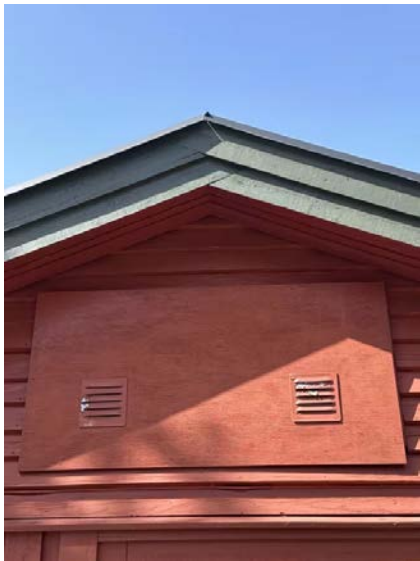
Adkomst for inspeksjon av loft/takkonstruksjon må etableres.
