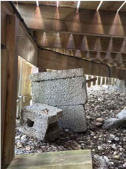
Fundament har konstruksjonssvikt og er underdimensjonert.
