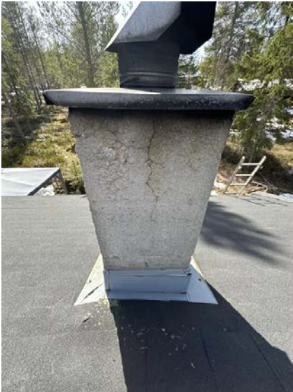
Det registreres sprekker i pipe.
