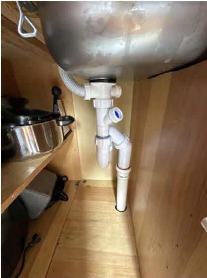
Viser avløpsinnstallasjoner under kum.
