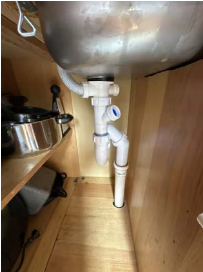
Viser avløpsinnstallasjoner under kum.
