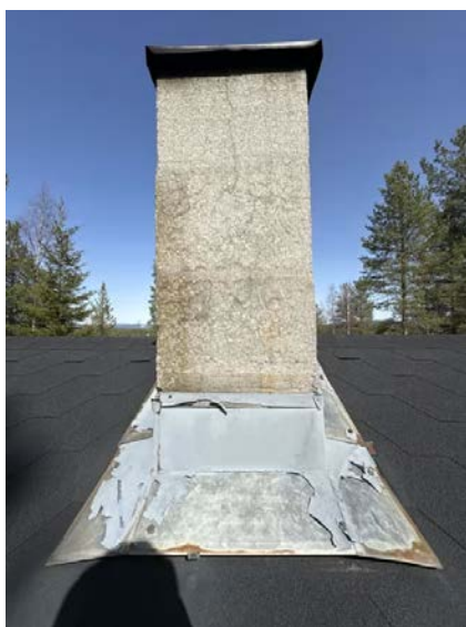
Viser rust og slittasje på beslag rundt pipe.
