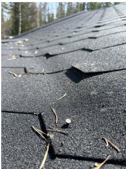
Pappshingel har stedvis løsnet. Det registreres spiker igjennom pappen.
