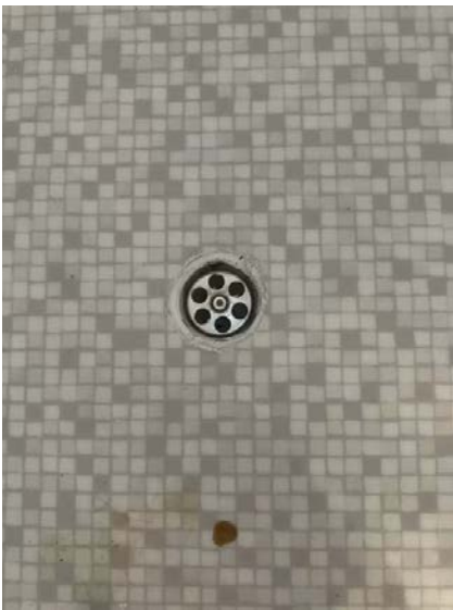
Viser sluk i dusjsone.
