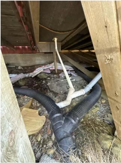
Plastrør/slanger under hytta til filtrering i grunnen.
