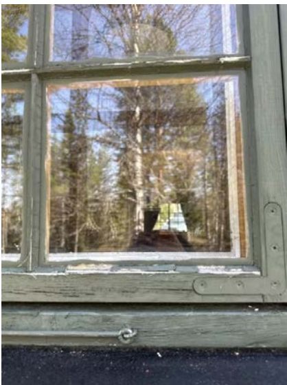
Kittfalsler (utvendig tetting mellom vindusramme og glass) er uttørket og stedvis løsnet.
