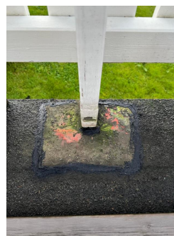
Stolper på terrasse mot vest, eier har utbedret med fugemasse.
