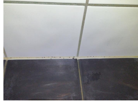
Misfarget silikonfuger i dusjsonen.
