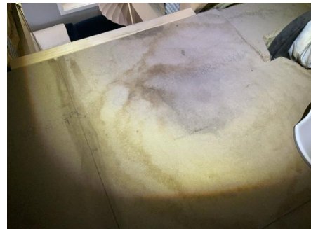
Synlige fuktskjolder under luftehett i takkonstruksjonen.
