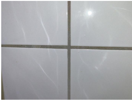
Slitte/misfarget fuger i dusjsonen.
