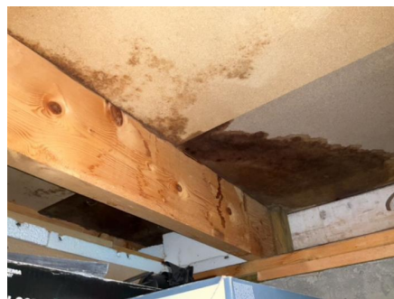
Fukt gjennomtrenging, synlig fra garasje i underetasje.
