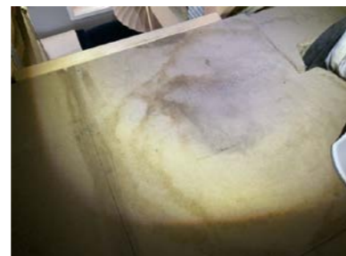
Synlige fuktskjolder under luftehett i takkonstruksjonen.
