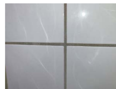
Slitte/misfarget fuger i dusjsonen.
