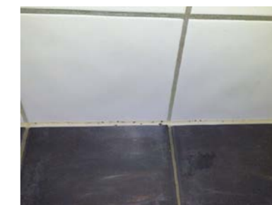
Misfarget silikonfuger i dusjsonen.
