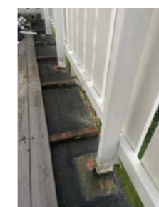
Stolper på terrasse mot vest, eier har utbedret med fugemasse.
