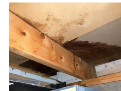
Fukt gjennomtrenging, synlig fra garasje i underetasje.
