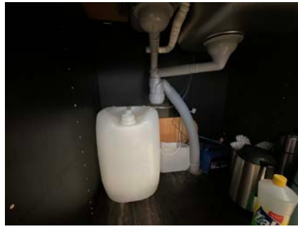
Rørapplegg under kjøkkenservant.
