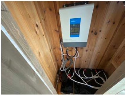
Inverter og batterier for solcelleanlegg.
