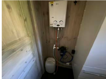
Gassanlegg for oppvarming av vann.
