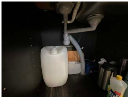
Røropplegg under kjøkkenservant.
