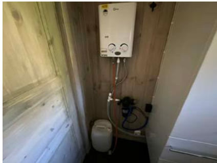
Gassanlegg for oppvarming av vann.
