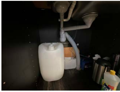
Rørapplegg under kjøkkenservant.
