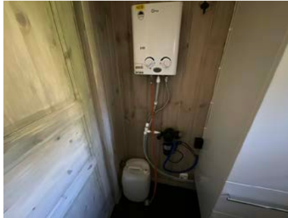
Gassanlegg for oppvarming av vann.
