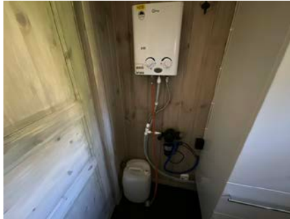
Gassanlegg for oppvarming av vann.
