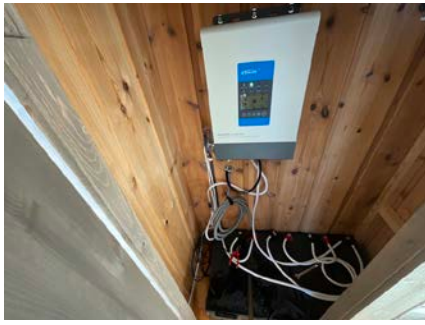
Inverter og batterier for solcelleanlegg.
