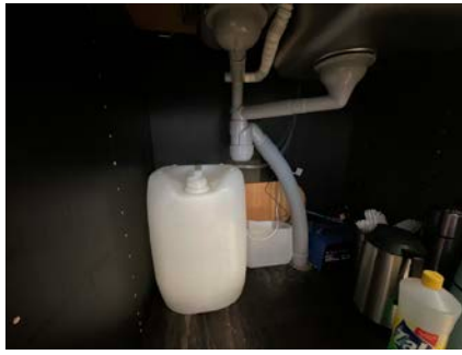
Rørapplegg under kjøkkenservant.
