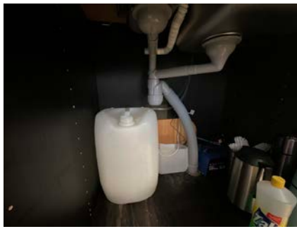
Rørapplegg under kjøkkenservant.
