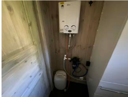
Gassanlegg for oppvarming av vann.
