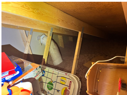
Tilluftkanal til ventilasjonsanlegg
