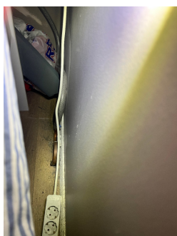
Drenering fra ventilasjons aggregat
