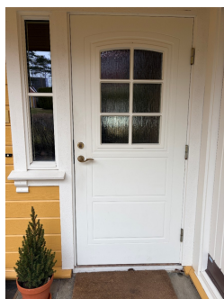
Noe bruksmerker på hovedinngangsdør
