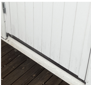
Noe malingsslitt utside av dør på soverom
