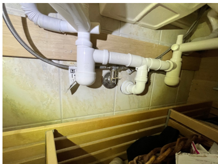
Tetting rundt rør bør undersøkes ytterligere
