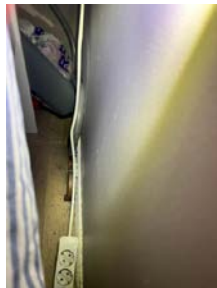
Drenering fra ventilasjons aggregat
