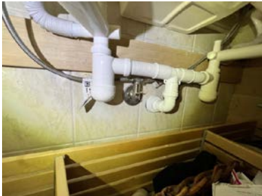
Tetting rundt rør bør undersøkes ytterligere
