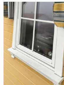
Slitasje/skade på overflate behandlingen
