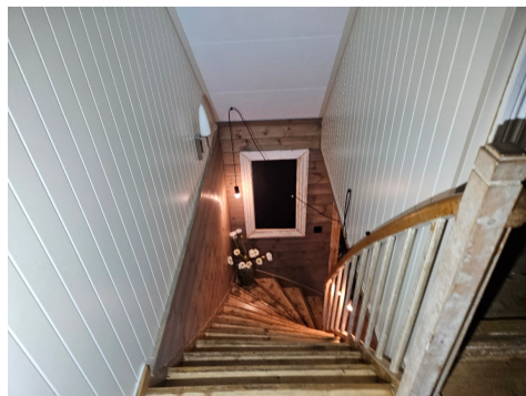
Trappen er utført uten håndløper på ene siden.
