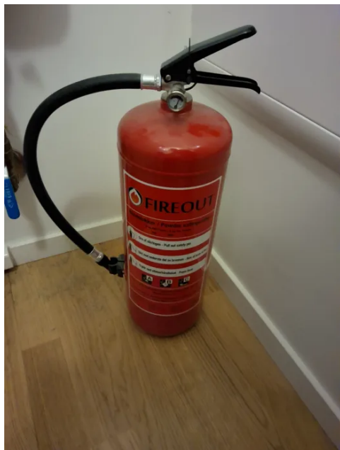
Brannslukningsapparat er plassert i bod.
