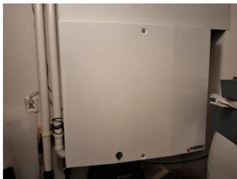
Ventilasjonsaggregat er plassert i bod/teknisk rom.
