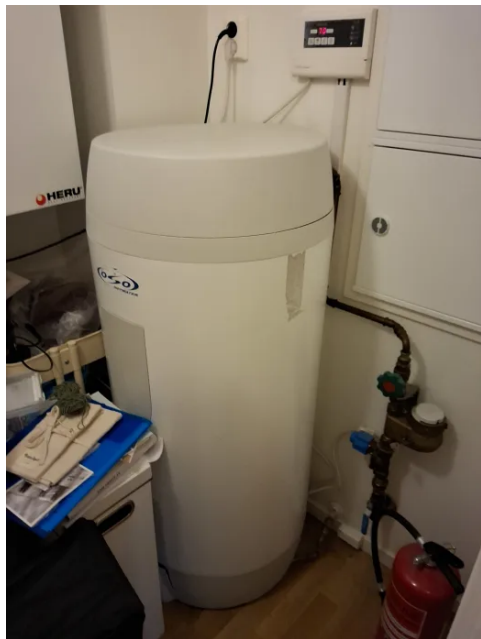
Varmtvannsbereder er plassert i bod/teknisk rom.
