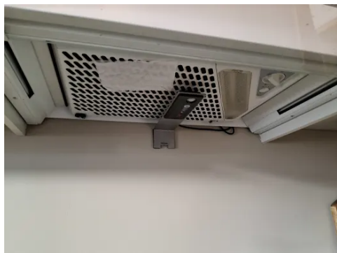
Avtrekkseffekt er testet med papir.
