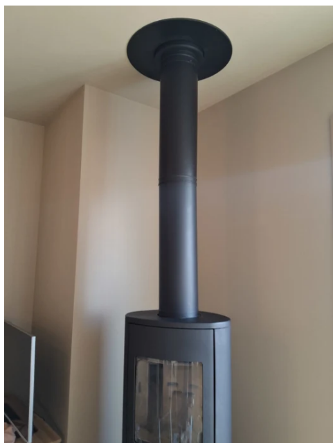
Vedovn med stålpipe i stue.
