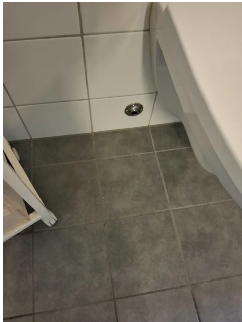
Avrenning fra innebygget toalettsisterne.
