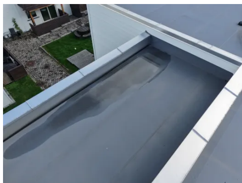
Det registreres vannsamling på taket over inngangspartiet.
