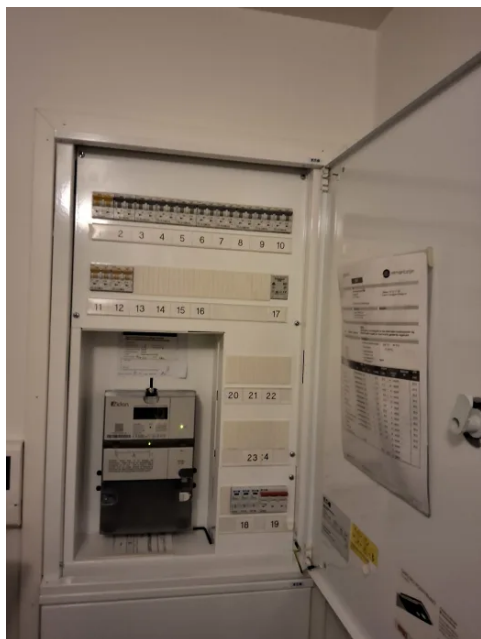
Sikringsskap med automatsikringer er plassert i bod/teknisk rom.
