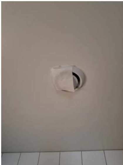
Avtrekkseffekt er testet med papir.
