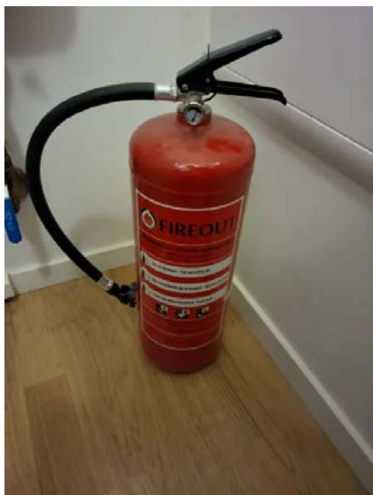
Brannslukningsapparat er plassert i bod.
