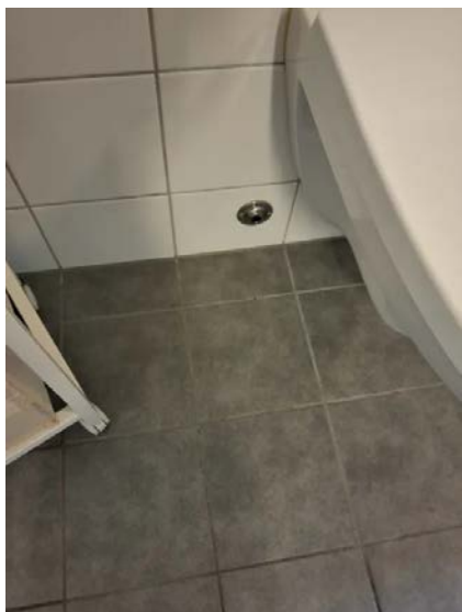
Avrenning fra innebygget toalettsisterne.
