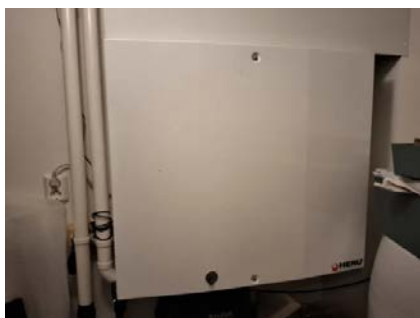
Ventilasjonsaggregat er plassert i bod/teknisk rom.
