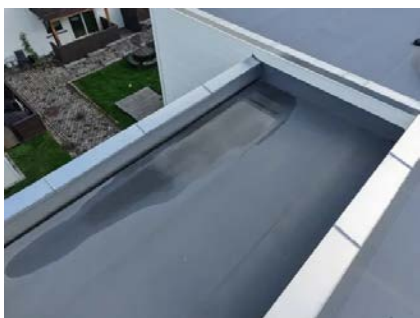
Det registreres vannsamling på taket over inngangspartiet.
