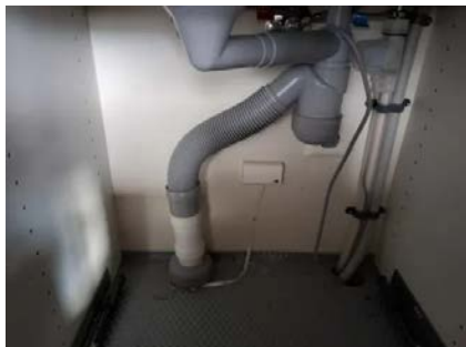
Leiligheten har synlige avløpsrør av plast.
