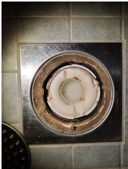
Sluket klemring er dekket av flislim.
