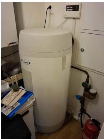
Varmtvannsbereider er plassert i bod/teknisk rom.
