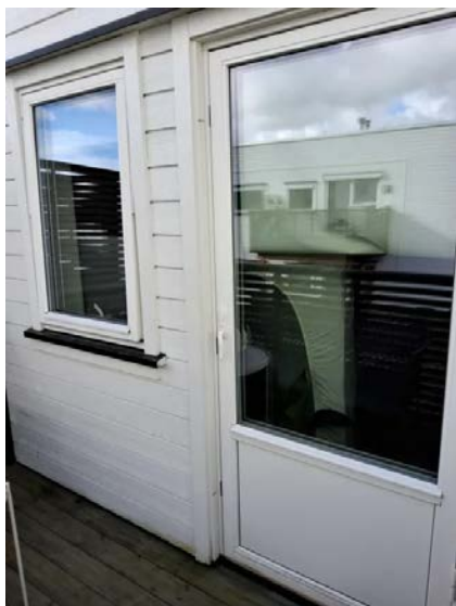
Leiligheten har vinduer og balkongdører med tre-lags glass.
