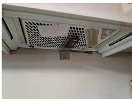
Avtrekkseffekt er testet med papir.
