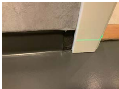
Utetthet i gulvbelegg ved døråpning.
