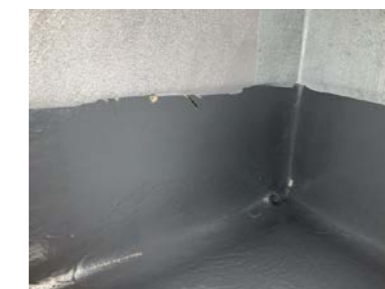
Liten sprekk i skjøt i oppkant på gulvbelegg.
