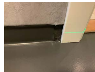
Utetthet i gulvbelegg ved døråpning.
