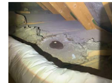
Fuktmerke på papp over isolasjon ved gjennomføring for ventilasjon i takflaten.
