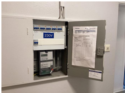
Sikringsskap lokalisert i felles gang.
