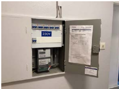
Sikringsskap lokalisert i felles gang.
