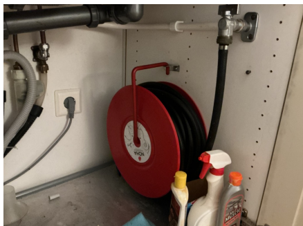
Husbrannslange plassert i kjøkkenbenk.
