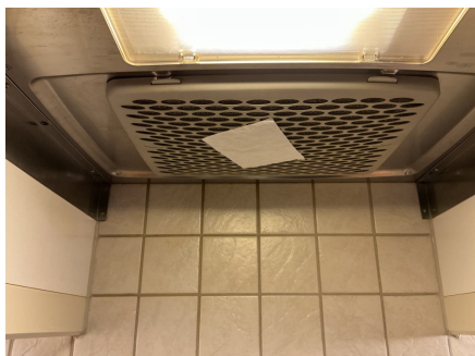
Avtrekkseffekten er testet med papir.
