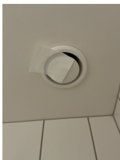
Avtrekkseffekten er testet med papir.
