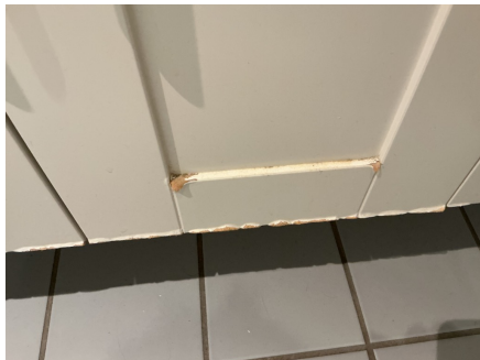
Svelleskader på innredning.
