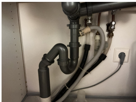
Leiligheten har synlige avløpsrør i plast.
