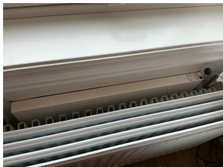
Tilluftsventiler bak radiatorer.
