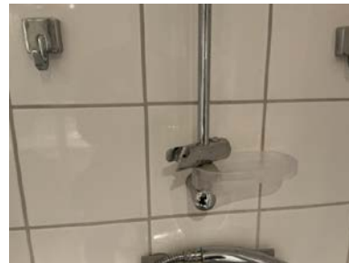
Defekt feste til dusjhode.
