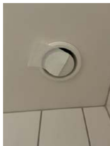
Avtrekkseffekten er testet med papir.
