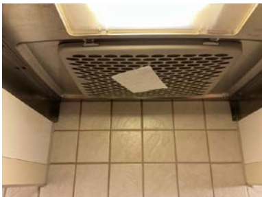
Avtrekkseffekten er testet med papir.
