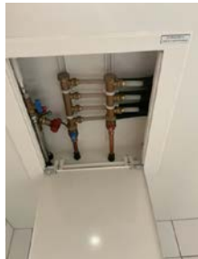
Fordelerskap for rør-i-rør med stoppekraner plassert i himling på bad.
