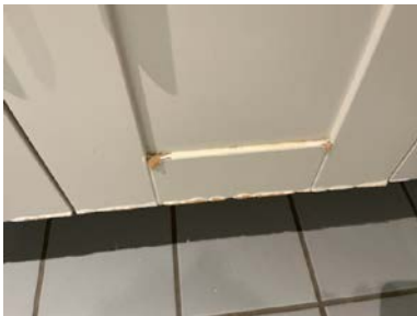
Svelleskader på innredning.
