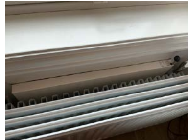
Tilluftsventiler bak radiatorer.
