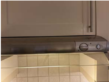
Mekanisk avtrekkseffekt reguleres fra kjøkkenventilator.
