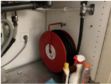
Husbrannslange plassert i kjøkkenbenk.
