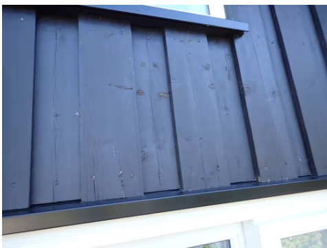
Deler av panel er ført helt ned til vannbrett og kan føre til nedfukting av panel og skader over tid. Dette er over tilbygd del over heve skyvedør
