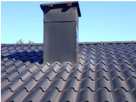
Rustdannelser/slitasje på beslag/takhatt.
