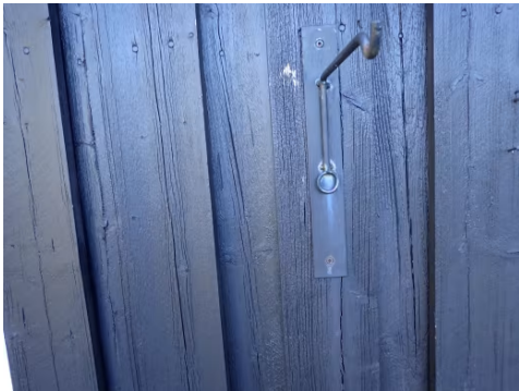
Eksempel på værslit og oppsprukket kledning.
