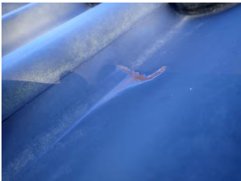
Eksempel på rustdannelser i takteking.
