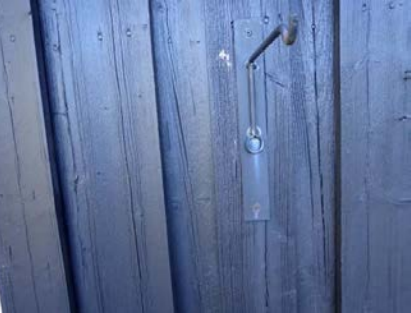
Eksempel på værslit og oppsprukket kledning.
