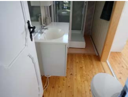
Bad med manglende tettesjikt og sluk i tilknytning rommet.
