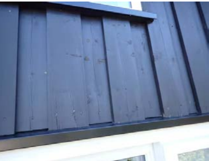
Deler av panel er ført helt ned til vannbrett og kan føre til nedfukting av panel og skader over tid. Dette er over tilbygd del over heve skyvedør
