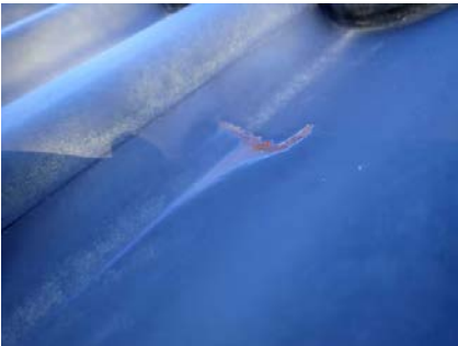
Eksempel på rustdannelser i taktekking.
