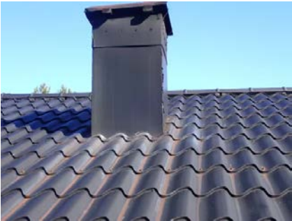
Rustdannelser/slitasje på beslag/takhatt.
