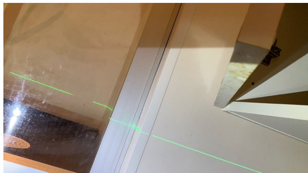
Svelling i dørblad til baderomsinnredningen.
