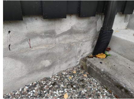
Noen sprekker ved inngangsparti.
