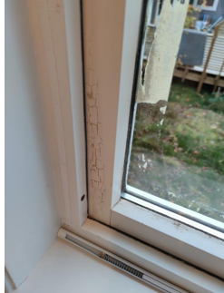
Tegn på innvendig kondensering av soveromsvindu.
