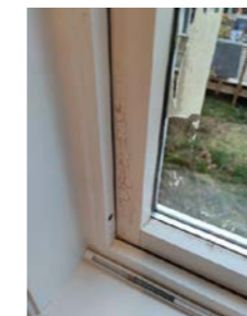
Tegn på innvendig kondensering av soveromsvindu.
