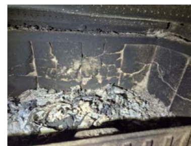
Sprekker i ildfast stein inne i ovnen.
