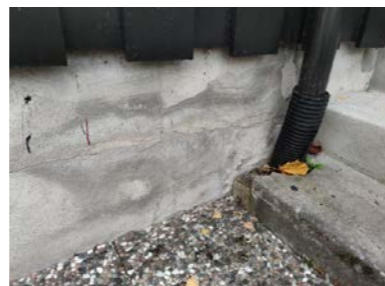
Noen sprekker ved inngangsparti.
