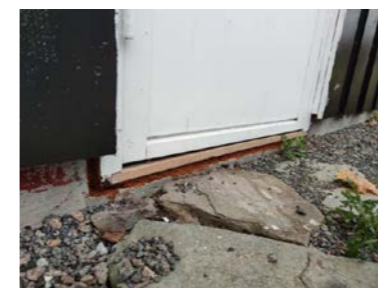
Fritt eksponert byggsaum under terrassedør.
