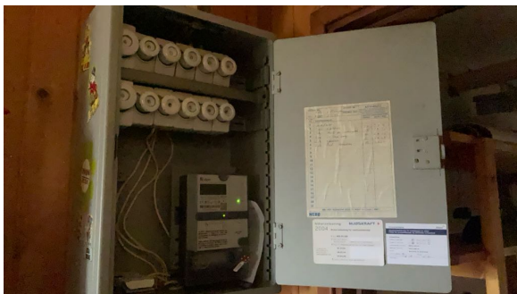
Sikringsskap i leilighet i kjeller.
