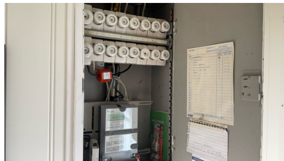
Sikringsskap i hoveddel
