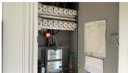
Sikringsskap i hoveddel
