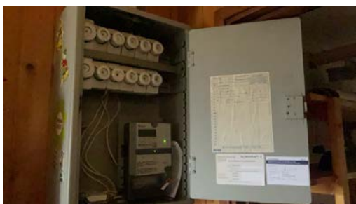
Sikringsskap i leilighet i kjeller.
