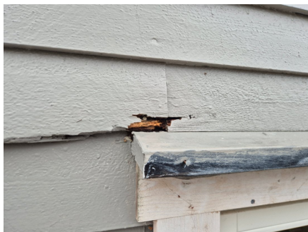
Råteskader i kledning.
