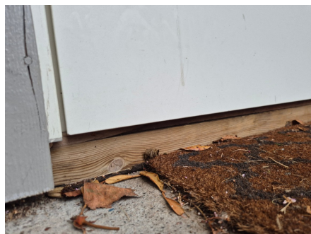
Knekt terskel og manglende beslag i underkant.
