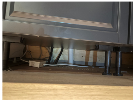
Ledning under kjøkkenbenk ikke festet.
