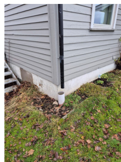
Manglende bortledning av takvann.
