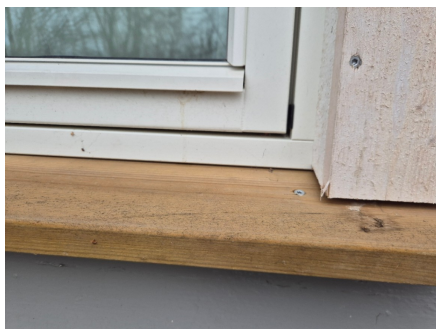
Mangler beslag på vannbrett.
