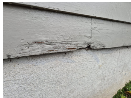
Råteskader i kledning.
