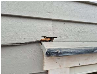
Råteskader i kledning.
