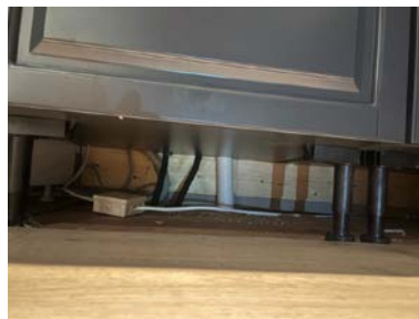
Ledning under kjøkkenbenk ikke festet.
