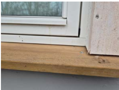
Mangler beslag på vannbrett.
