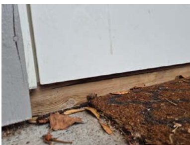
Knekt terskel og manglende beslag i underkant.
