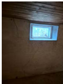
Sprekker og skråriss i grunnmur.
