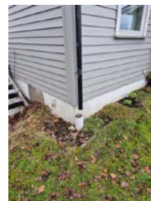
Manglende bortledning av takvann.
