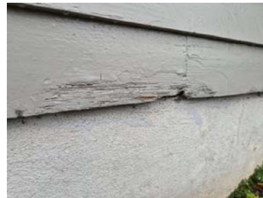
Råteskader i kledning.
