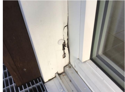
Råteskader i nedkant dørkarm
