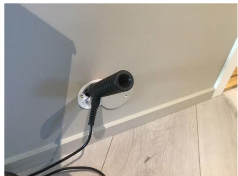
Fukt måling i vegg under vannskap
