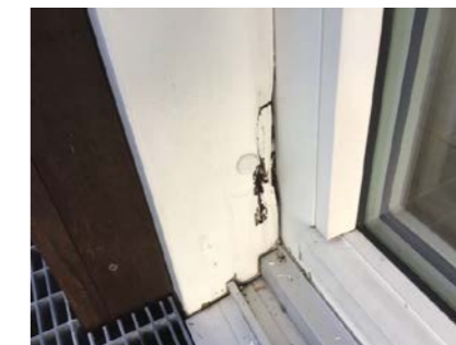
Råteskader i nedkant dørkarm
