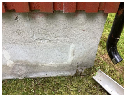
Eksempel på utvendig skråriss.
