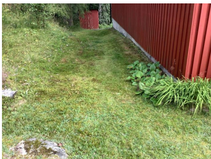
Utilfredsstillende fall fra bygning.
