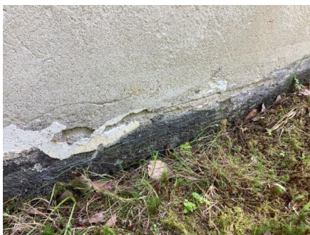
Eksempel på utvendig horisontalriss.
