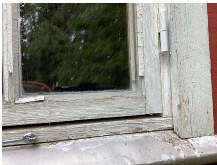
Eksempel på værslitt vindu med mangelfull kitt.
