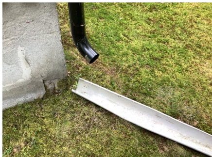
Utilfredsstillende bortledning av takvann.
