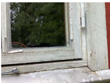
Eksempel på værslitt vindu med mangelfull kitt.
