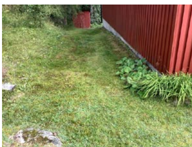
Utilfredsstillende fall fra bygning.
