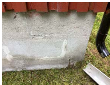
Eksempel på utvendig skråriss.
