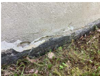
Eksempel på utvendig horisontalriss.
