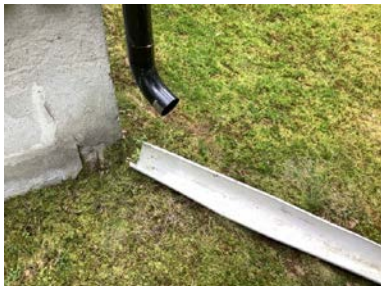
Utilfredsstillende bortledning av takvann.
