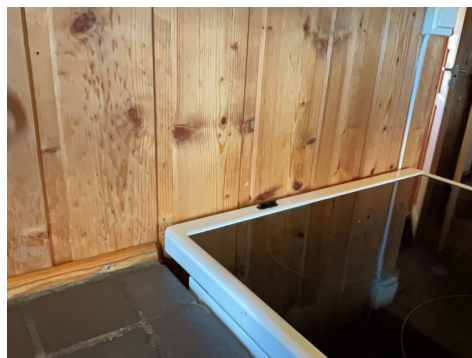
Merker på vegg ved bruk av komfyr som årsak
