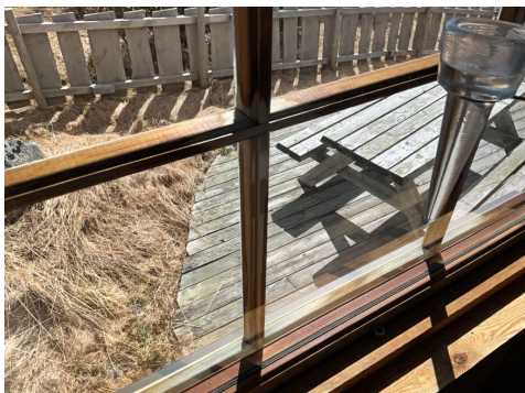
Skjolder i karm, trolig som følge av kondens mellom glass
