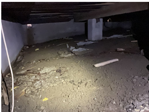
Jordholdige masser til grunn, fuktige masser på befaring som forårsaker fuktig miljø i kryprom
