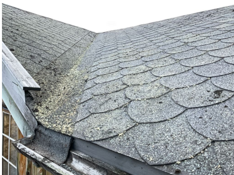
Slitasje med mose på tekking
