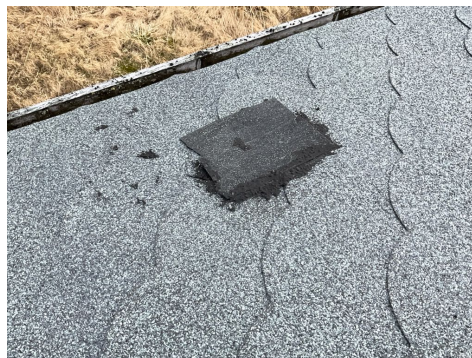
Foretatt lokal tetting av nrliggende tidligere lufting over tak, bør holdes under tilsyn
