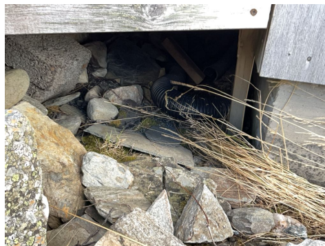
Terrengfall mot bygning på overside, bør endres og føres vekk fra bygningskropp for å unngå oppfukting av yttermurer og kryprom
