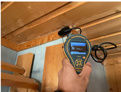
Fuktskjolder ved pipestamme, ved fuktmåletaking var det ikke fuktutslag
