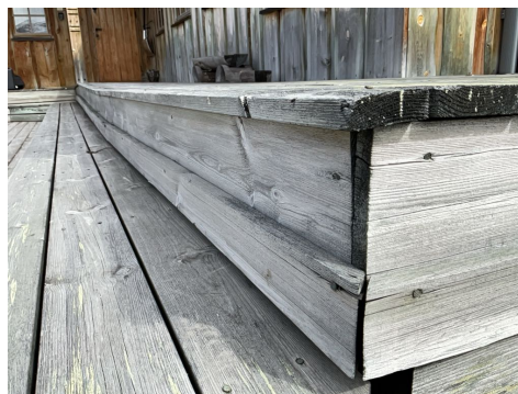
Skjevheter av terrasse konstruksjoner
