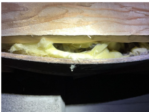
Fra luke ble åpning i gulvkonstruksjon synlig med spor av aktivitet fra mus/skadedyr
