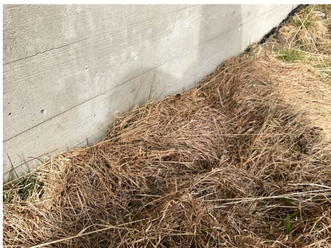
Avsluttet under mur, fare for fuktinntregning
