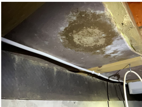
Muggsopp på stubloftsplater
