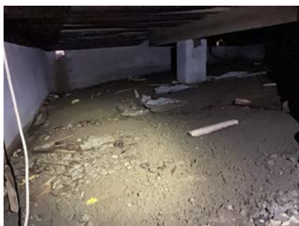
Jordholdige masser til grunn, fuktige masser på befarings som forårsaker fuktig miljø i kryprom
