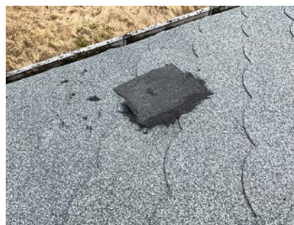
Foretatt lokal tetting av nrliggende tidligere lufting over tak, bør holdes under tilsyn
