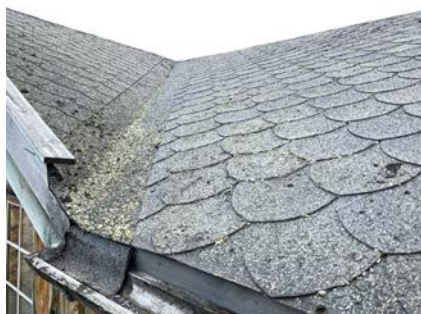
Slitasje med mose på tekking
