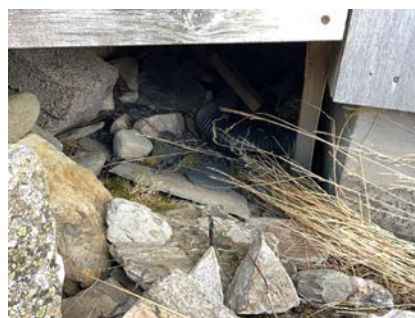
Terrengfall mot bygning på overside, bør endres og føres vekk fra bygningskropp for å unngå oppfukting av yttermurer og kryprom
