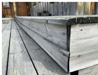
Skjevheter av terrasse konstruksjoner
