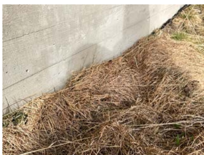
Avsluttet under mur, fare for fuktinntregning
