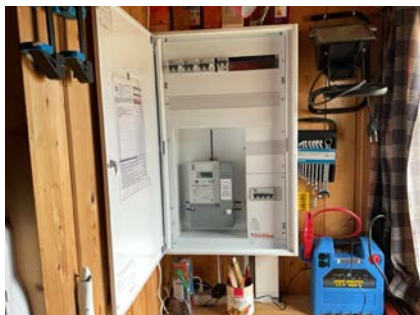
Sikringsskap, bemerket manglende deksel på toppskinne siden av automatsikringer
