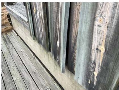
Vridninger og kvinger av ytterkledning, må påregnes utskifting av kledning på en side. Fare for innganger av mus/skadedyr
