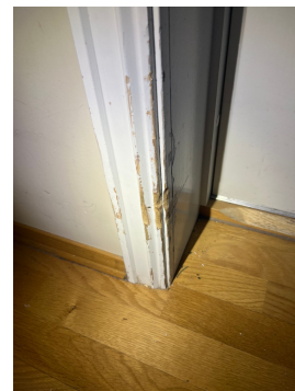
Slitasje på utforing/list til ytterdør.
