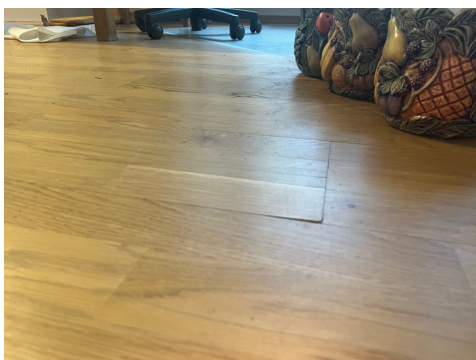
Parkett har slitasje.
