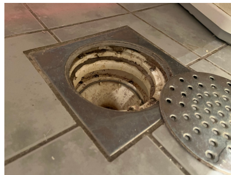
Sluk under servantskap.
