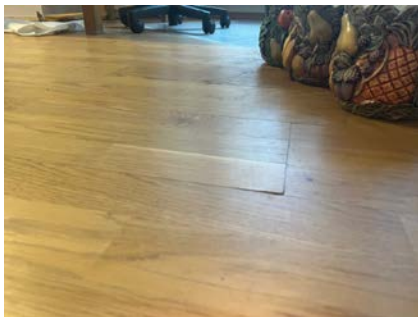
Parkett har slitasje.
