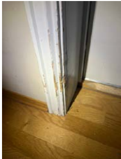
Slitasje på utforing/list til ytterdør.
