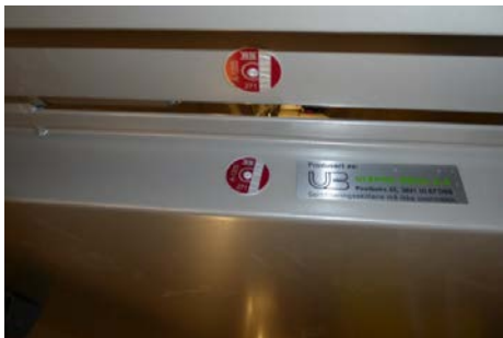
Klassifiseringsskilt på branndør i stål.
