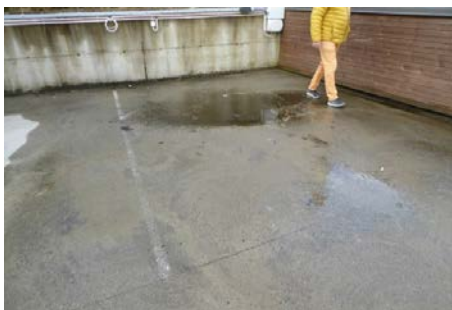
Stående vann på dekket ved biloppstillingsplasser.
