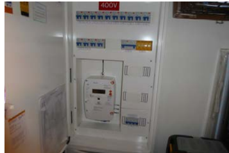
Underfordelingskap for leilighet.
