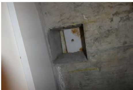
Lekkasjepunkt i fellesarealer Kompasset.
