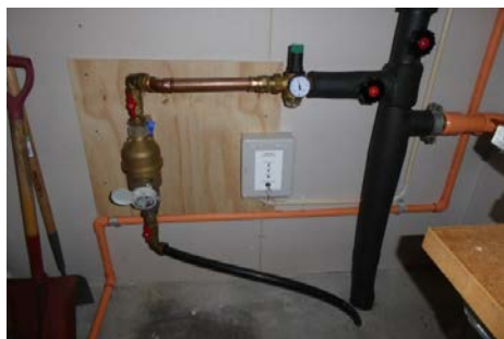
Vanninnlegg med reduksjonsventil og trykkmåler.
