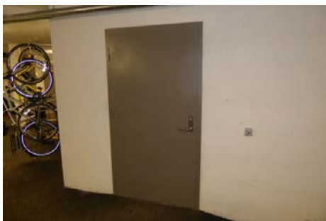
Branndør i stål mellom garasje og bodarealer.
