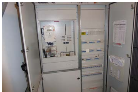
Hovedfordelingstavle med el-inntak.
