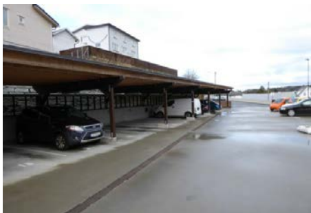
Bildet viser dreneren med ansamlinger av vann på flere pkt.
