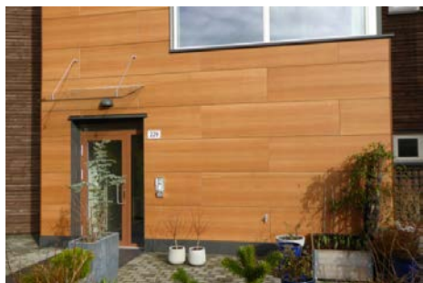
Veggparti med fasadeplater - stedvise flekker fugleskitt.
