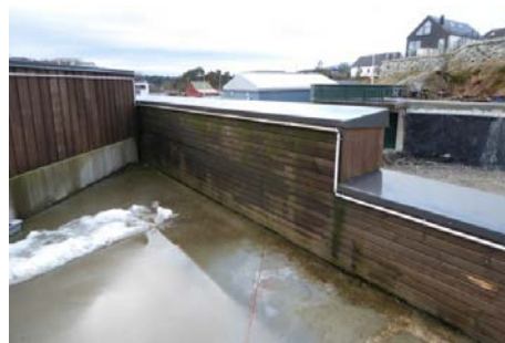
Parti på parapetvegg ved biloppstillingsplasser med grønske.
