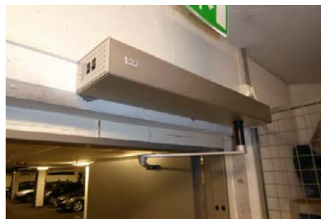
Elektrisk dørpumpe på branndør til garasjeanlegg.
