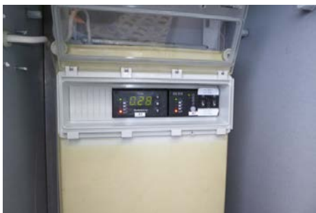
Styringsenheden for pumpeanlegget.
