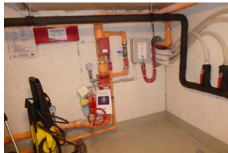
Sprinkelsentral i trappeoppgang.
