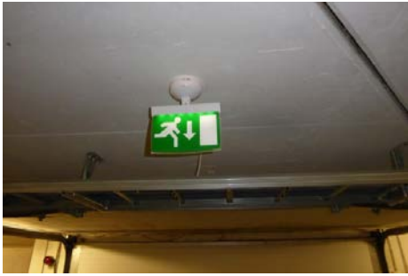
Nød- og ledelys plassert i garasjeanlegg.
