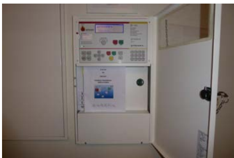
Sentral for brannvarslingsanlegg.
