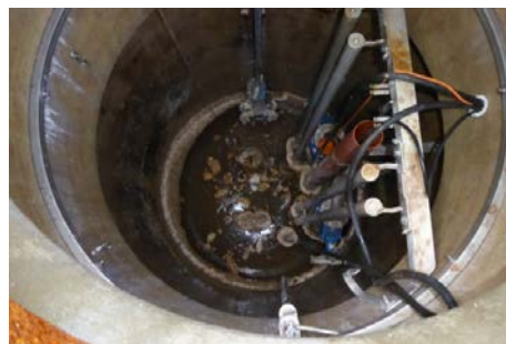
Pumpekum med pumper.
