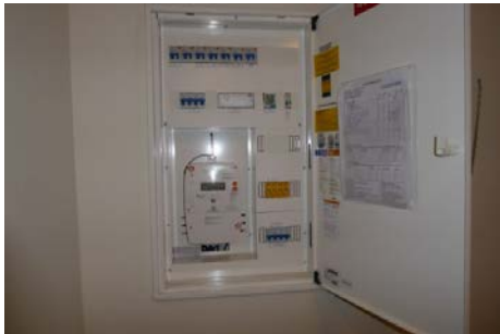
Fordelerskap for fellesarealer i et av byggene.
