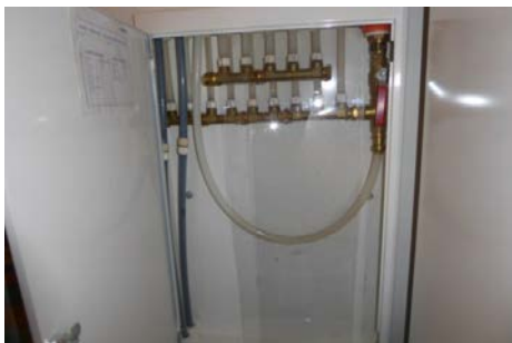
Fordelingsskap med hovedstoppekran i leilighet.
