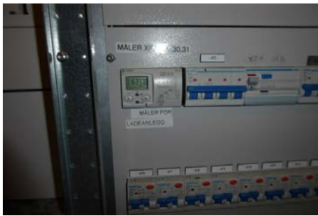
Måler for ladeanlegget el-bil.
