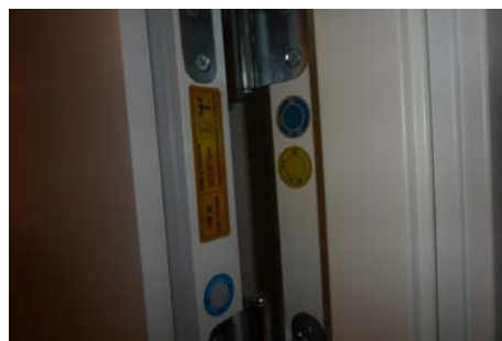
Klassifiseringsskilt på brannndør til sprinkelsentral.
