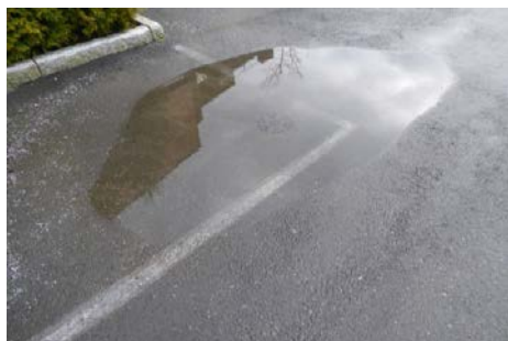
Vannansamling ved tett overvannssluk.
