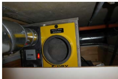
Bildet viser aggregatet innebygget i kasse.
