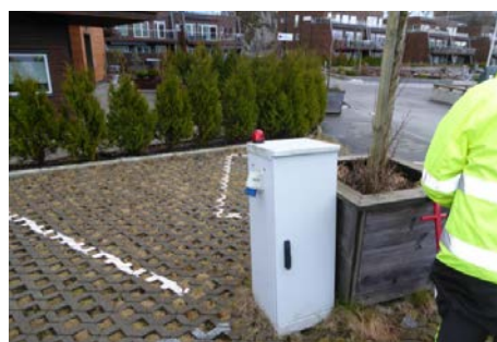
Styringsboks for pumpeanlegg, med visuell alarm.
