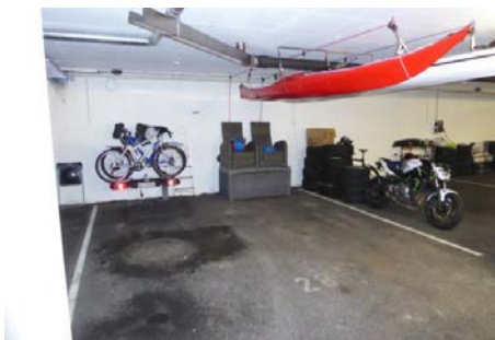
Lekkasjepunkt i garasje, med provisorisk renneløsning.
