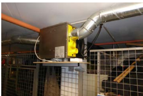
Plassering av adsorpsjonsavfukter i bodarealer Kompasset.
