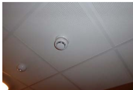
Røykdetektor tilknyttet alarmanlegg.
