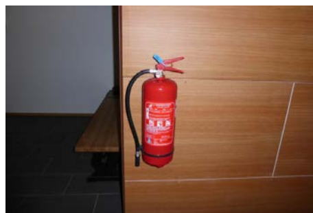
Pulverapparat for manuell slukning på fellesareal.
