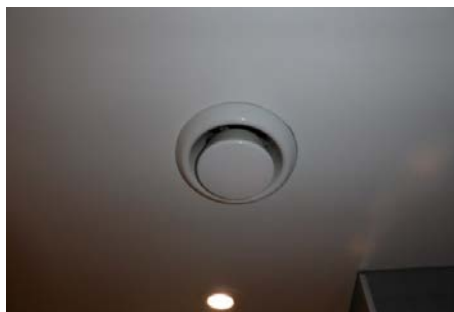
Avtrekkssventil på ventilasjonsanlegget.
