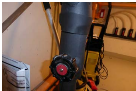
Hovedstoppekran på vanninnlegget i bygget.
