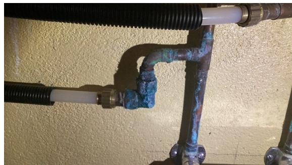
Stedvis korrosjon på skjøter.
