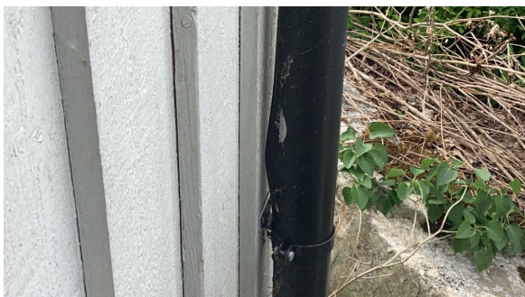
Frostsprenng på nedløp.
