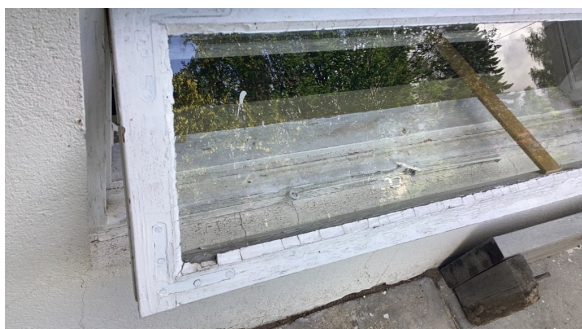
Eksempel på slitasje.
