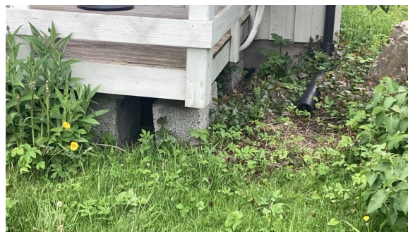
Skjevhet på fundament.
