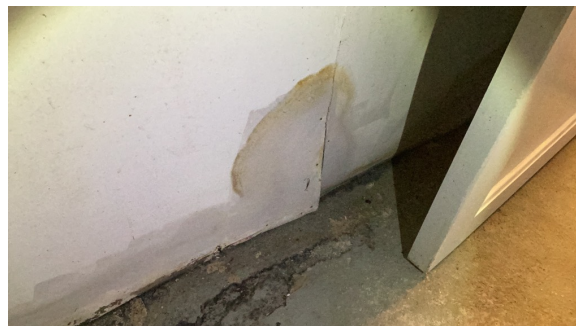
Det er fuktskader på delevegger av tre.
