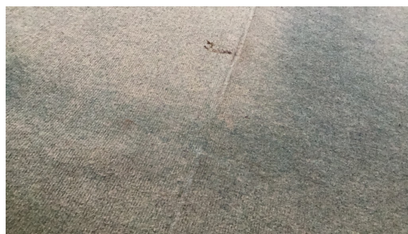
Slitasje og bølger i teppe.
