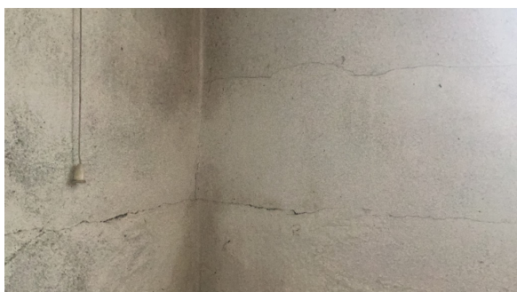
Eksempel på sprekker.
