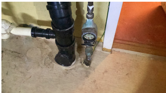
Vanninntak med stoppekran i kjeller.
