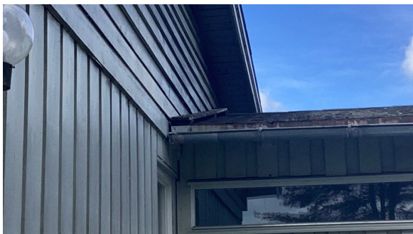
Det er ikke beslag i overgang mot garasje.
