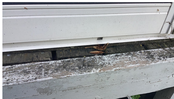
Gulv stikker ut på undersiden av dører. Trekker inn fuktighet og har råteskade.
