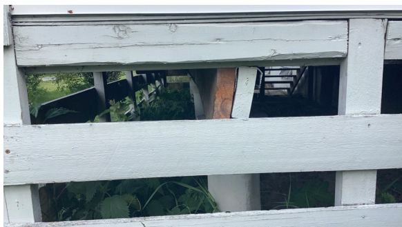
Vridning på bjelke under veranda.
