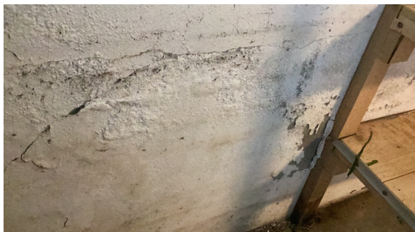
Fuktpåkjenninger på murvegger
