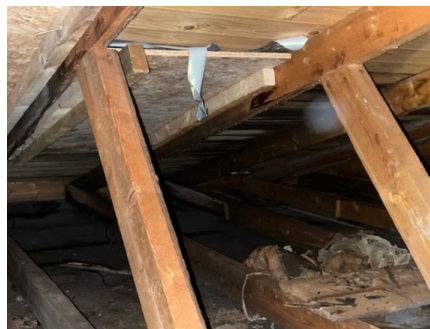
Det er mørke felter etter fuktighet på taktro
