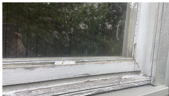
Eksempel på slitasje.
