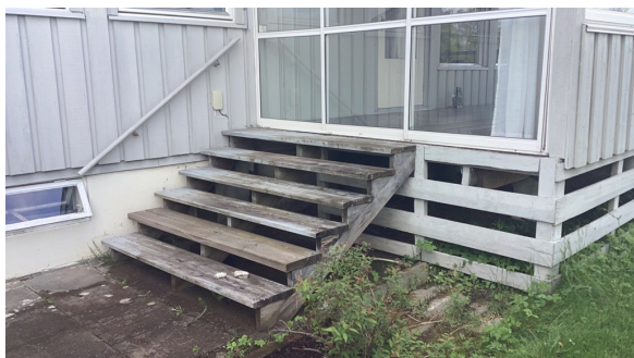
Stedvis slitasje å overflater.
