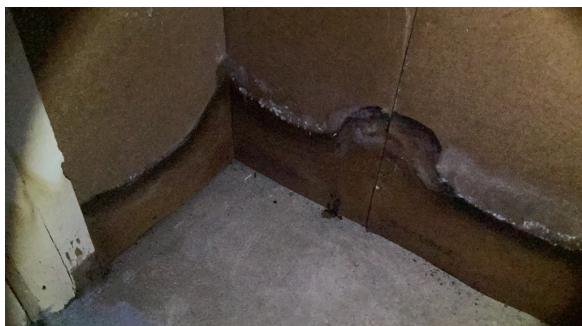
Det er fuktskader på delevegger av tre
