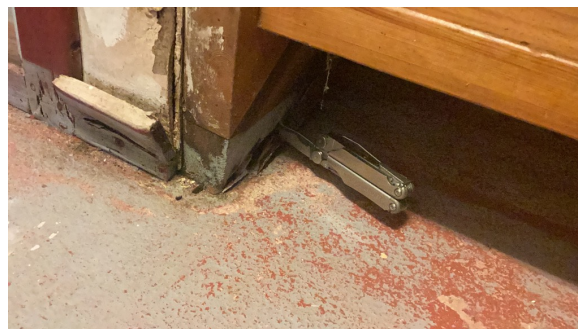
Råteskade nederst på trapp
