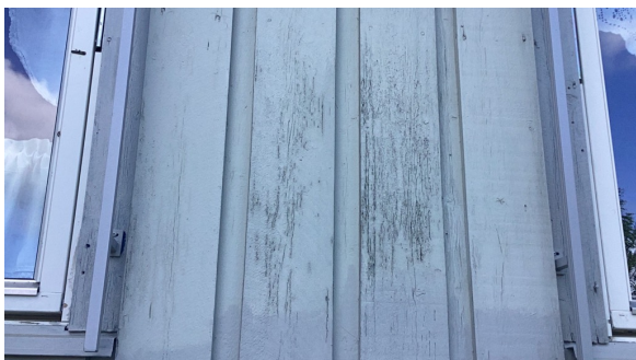
Eksempel på misfarging/slitasje.
