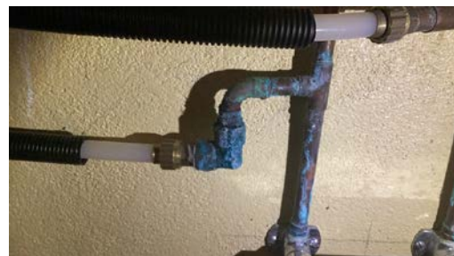
Stedvis korrosjon på skjøter.
