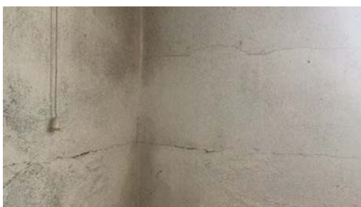
Eksempel på sprekker.
