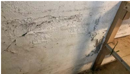
Fuktpåkjenninger på murvegger
