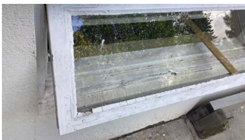
Eksempel på slitasje.
