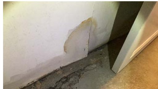
Det er fuktskader på delevegger av tre.
