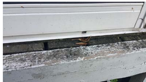
Gulv stikker ut på undersiden av dører. Trekker inn fuktighet og har råteskade.
