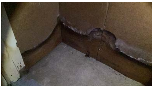
Det er fuktskader på delevegger av tre
