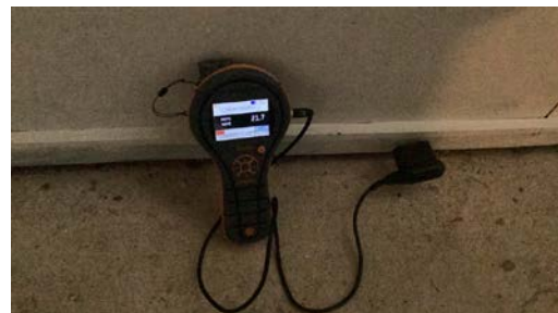
Høyt fuktinnhold i utforede vegger mot terreng.
