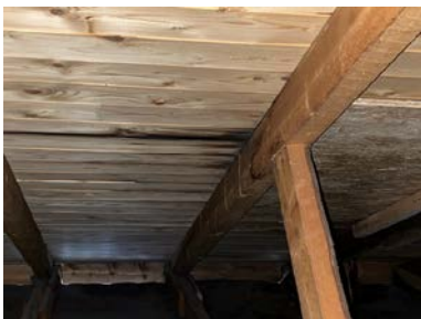
Det er mørke felter etter fuktighet på taktro
