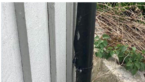
Frostspreng på nedløp.
