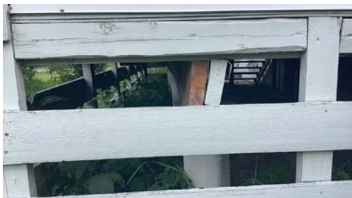
Vridning på bjelke under veranda.
