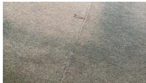
Slitasje og bølger i tepper.
