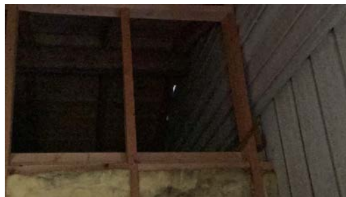
Det er utett overgang mellom vegg og boder.
