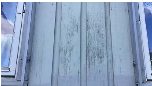
Eksempel på misfarging/slitasje.
