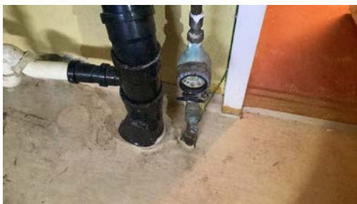
Vanninntak med stoppekran i kjeller.
