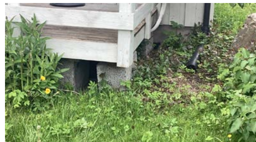
Skjevhet på fundament.
