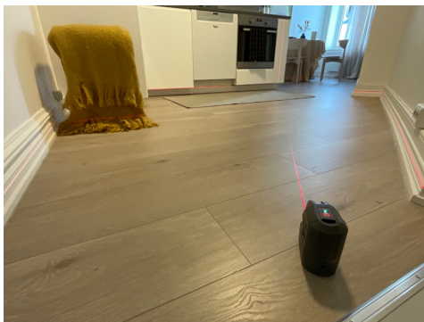
Nivellering spise kjøkken, avvik ca. 15-30 mm
