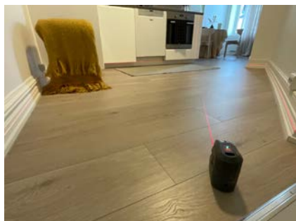
Nivellering spise kjøkken, avvik ca. 15-30 mm
