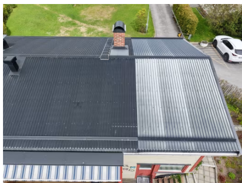
Deler av taktekingen er værslitt og bærer preg av alder.
