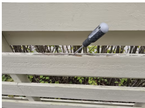
Det registreres enkelte råteskader i rekkverket.
