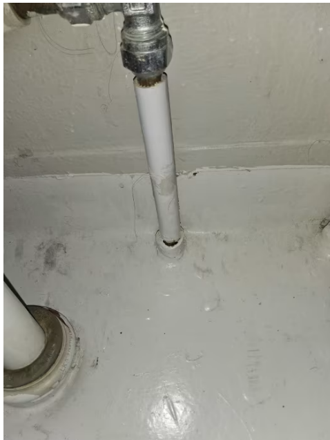
Utetthet rundt rørgjennomføring.
