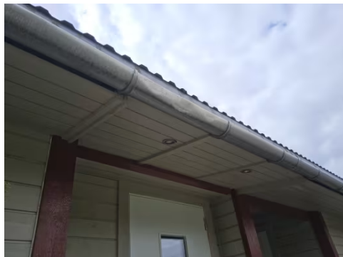
Det registreres bulker i takrenner.
