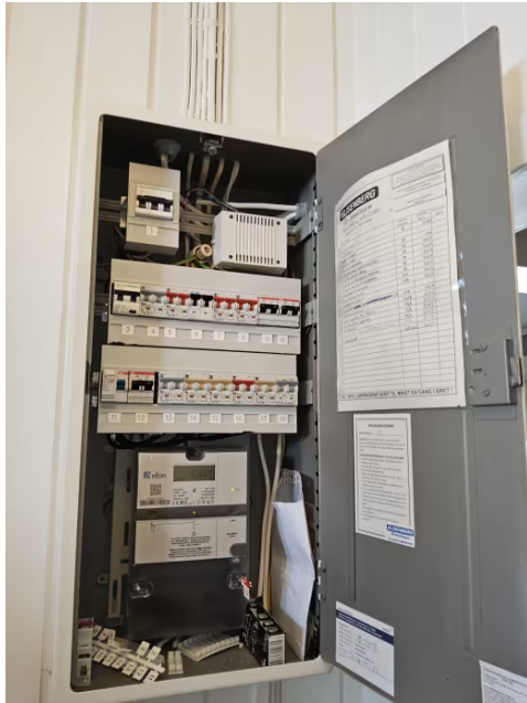
Sikringsskap er plassert i trappegang.
