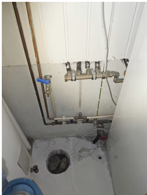
Hovedstoppkran er plassert i kjelleretasje.
