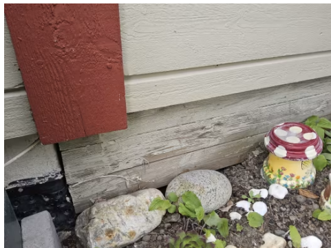
Deler av kledningen er værslitt.
