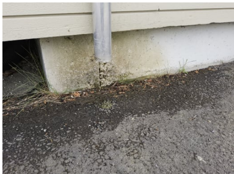
Taknedløp er avsluttet over bakken uten utkast.
