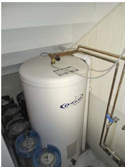
Varmtvannsbereder er plassert i gang under trapp i kjelleretasjen.
