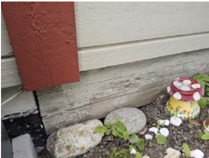
Deler av kledningen er værslitt.
