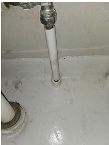
Utetthet rundt rørgjennomføring.
