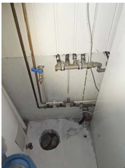
Hovedstoppekran er plassert i kjelleretasje.
