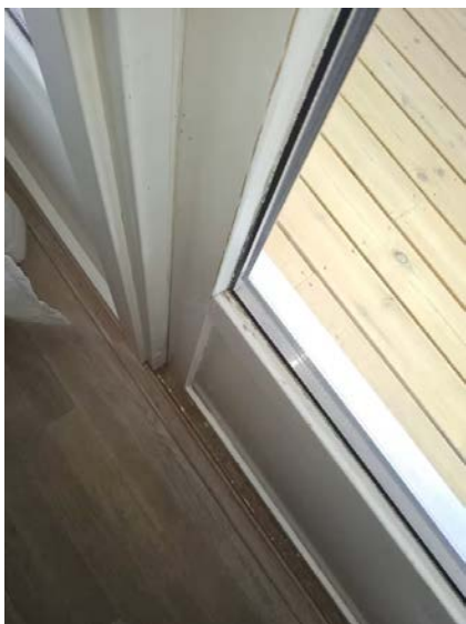
Symptomer etter kondens (krakelert maling) er registrert i enkelte vinduer.
