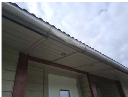
Det registreres bulker i takrenner.
