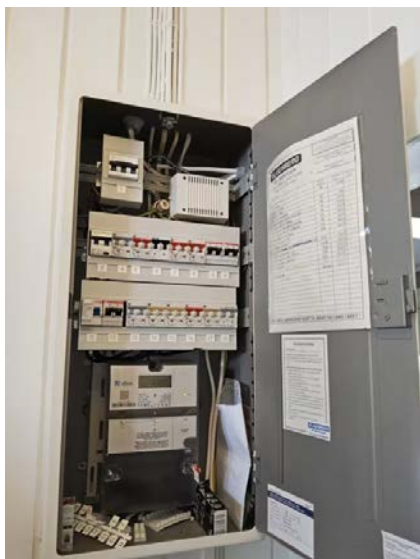
Sikringsskap er plassert i trappegang.
