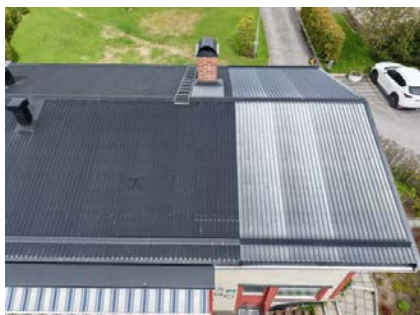
Deler av taktekkingen er værslitt og bærer preg av alder.
