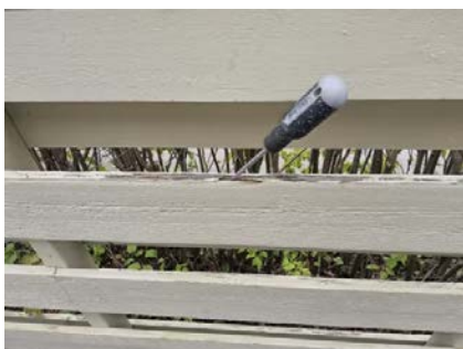
Det registreres enkelte råteskader i rekkverket.
