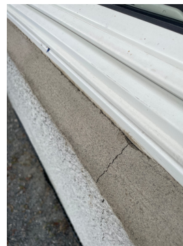
Begynt sprekker mellom puss og karm.
