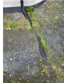
Synlig skader/deformasjon i drensør.
