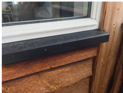
Eksempel på værslitt karm utvendig.
