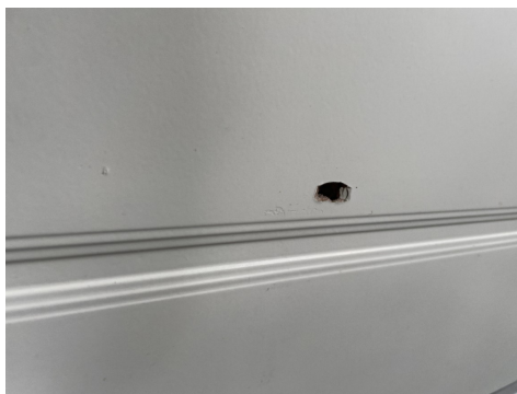
Skade i ytterdør 2. etasje.
