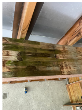
Synlig lekkasje fra tiltaksplater.
