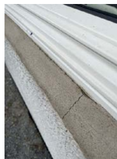
Begynt sprekker mellom puss og karm.
