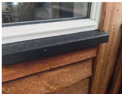
Eksempel på værslitt karm utvendig.
