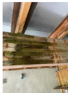
Synlig lekkasje fra tiltaksplater.
