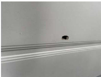
Skade i ytterdør 2. etasje.
