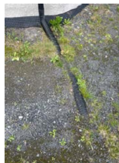
Synlig skader/deformasjon i drensør.
