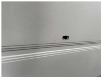
Skade i ytterdør 2. etasje.
