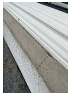
Begynt sprekker mellom puss og karm.
