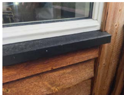
Eksempel på værslitt karm utvendig.
