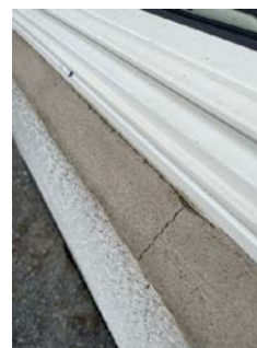
Begynt sprekker mellom puss og karm.
