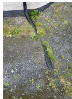
Synlig skader/deformasjon i drensør.
