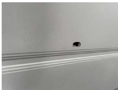
Skade i ytterdør 2. etasje.
