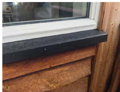
Eksempel på værslitt karm utvendig.
