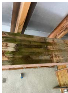
Synlig lekkasje fra tiltaksplater.
