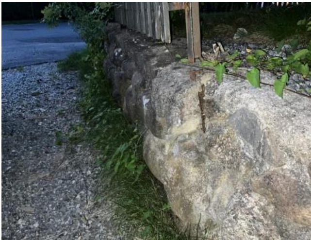
Sprekk i støttemur av naturstein.
