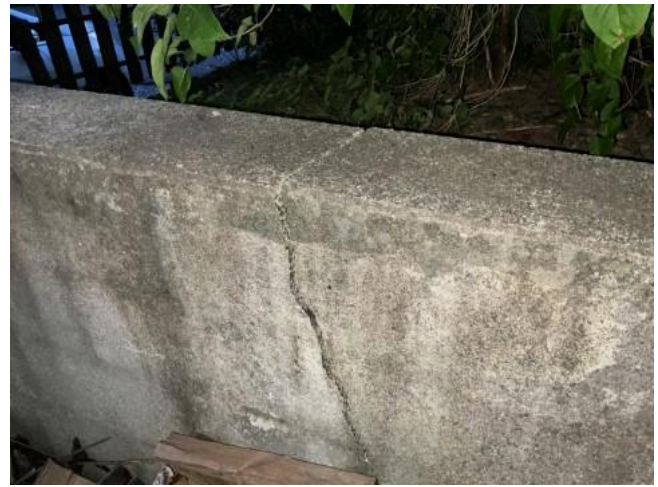
Sprekk i støttemur av leca.
