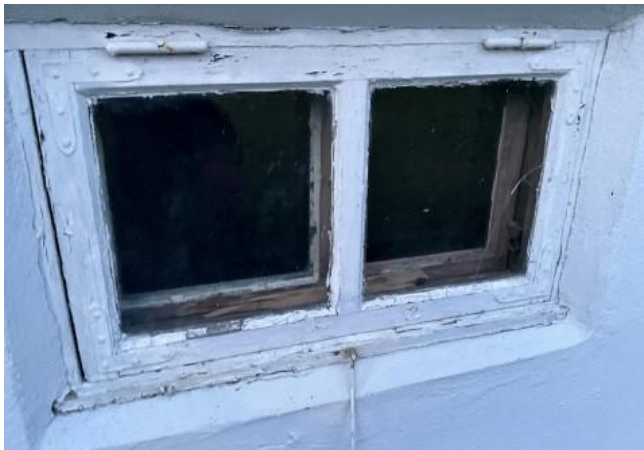
Avflaset maling og sprekk i kjellervindu.
