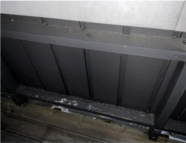
Bilde av avflasket maling og råte i nedre bjelkelag som holder panelet til rekkverket.
