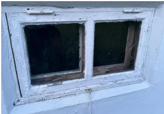
Avflaset maling og sprekk i kjellervindu.
