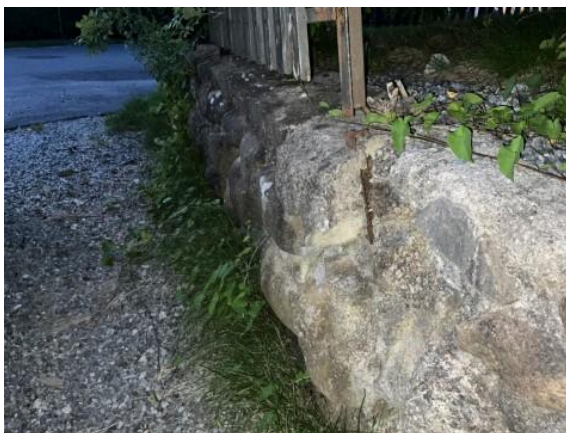
Sprekk i støttemur av naturstein.
