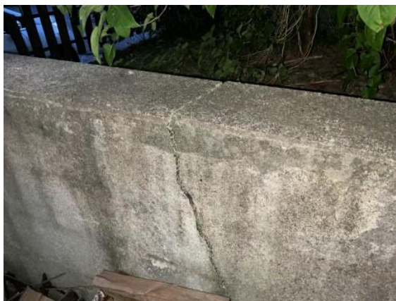
Sprekk i støttemur av leca.
